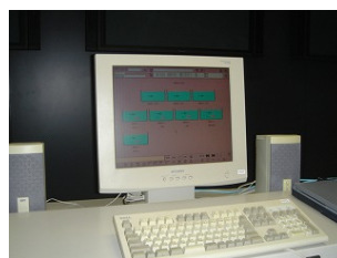
pH監視モニター
