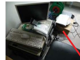
室内ユニットは廊下に設置
