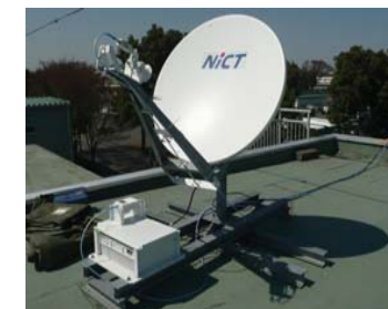
入間基地に設置した51M-VSAT
