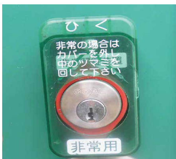
写真 4 非常時は、カバーを外し中のつまみを回して開錠するタイプ
