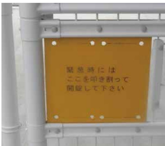
写真 3 緊急時は、ノブの横を壊し開錠するタイプ
