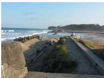
写真 99 村上海岸の堤防の状況 (南相馬市小高区)
