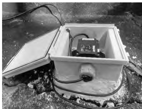
図2 地震計の設置状況
