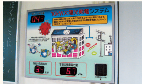
太陽光発電システムパネルの表示(附属坂出中学校)
