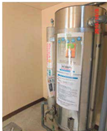
写真4 水保管補給装置
