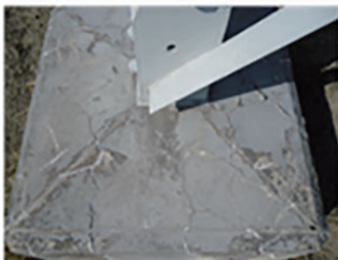
ASR 損傷を受けた鉄塔基礎
