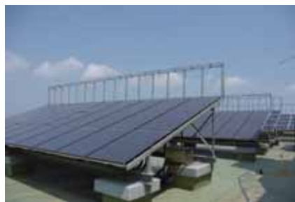
林町キャンパスに設置された 太陽光発電パネル
