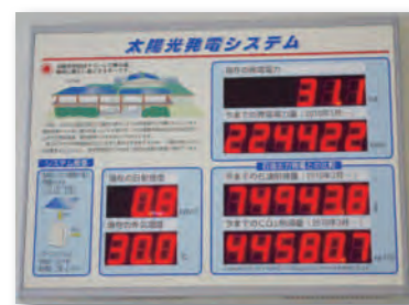
太陽光システムパネル表示
