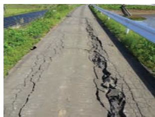
堤軸方向にクラックの発生 → せん断すべり破壊
