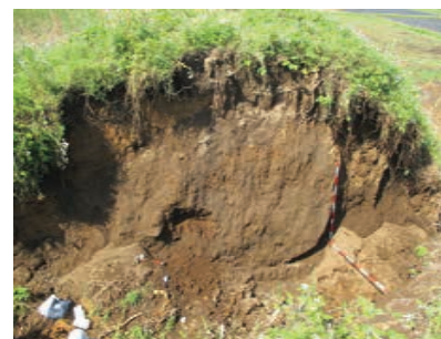
決壊断面の状況
