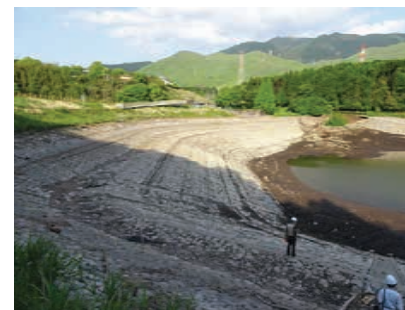
左岸側から被災した堤体部を望む
