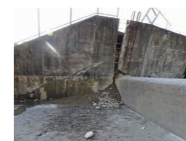
洪水吐の側壁の被害
