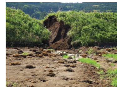
農地への貯留水の流入被害
