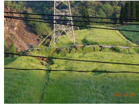
旧道の寸断と鉄塔脚部段丘崖の崩壊
