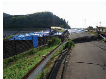
洪水吐部に生じた段差
