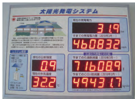
太陽光発電システムパネルの表示
