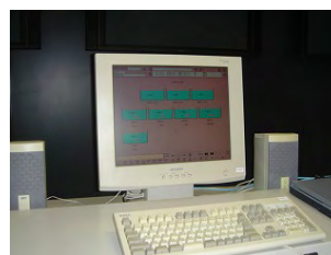
pH監視モニター
