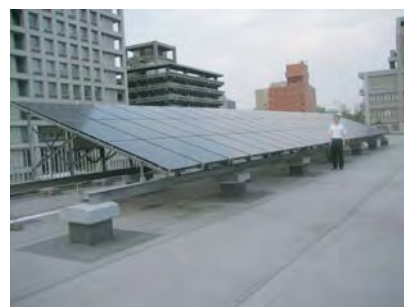
屋上に設置されている太陽光パネル
