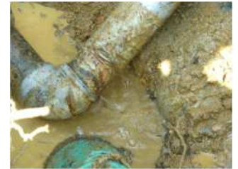
老朽化した屋外給水管
