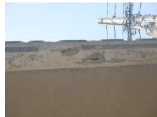
劣化により軒裏コンクリートが剥落
