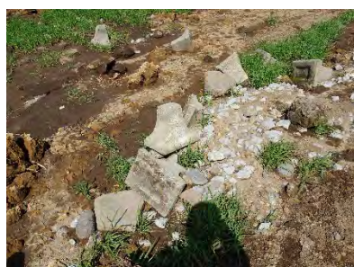
(d) 裏のり腰ブロックの流出
