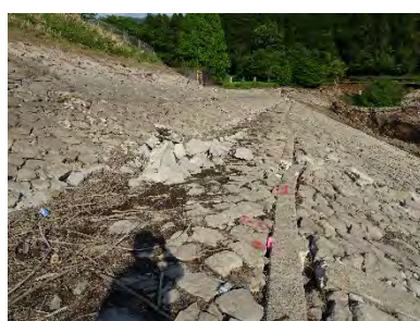
(b) コンクリート枠の圧縮破壊
