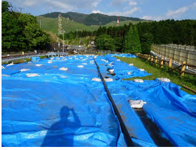
(e) 堤体クラックを覆うシート
