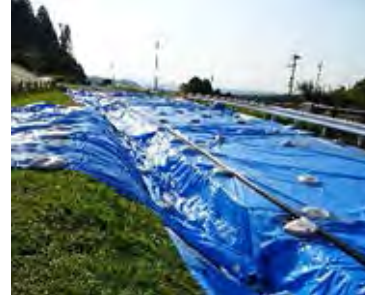
(f) 道路との境に生じたクラック
