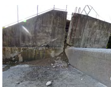
(c) 洪水吐の被害
