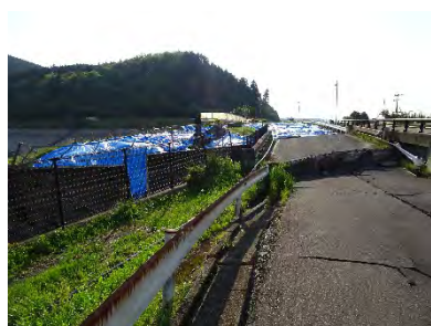
(d) 堤体天端に生じた段差
