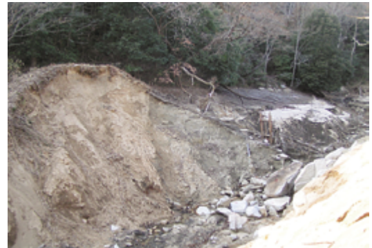
写真5 本堤決壊の事例
