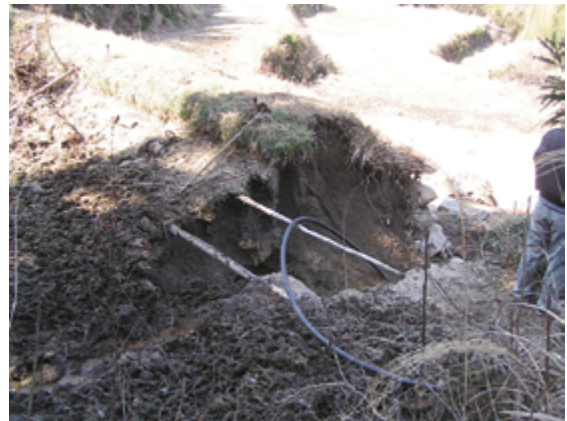
写真1 小規模ため池決壊の一例
