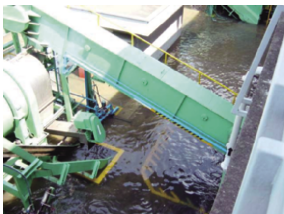
写真6 福岡ポンプ場の沈砂搬出機・洗浄器付近
