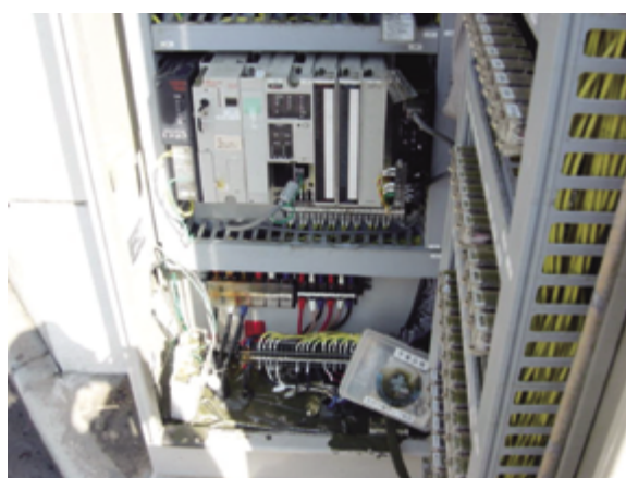
写真4 香西ポンプ場のポンプ操作盤
