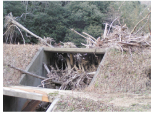
写真4 流木による洪水吐の閉塞
