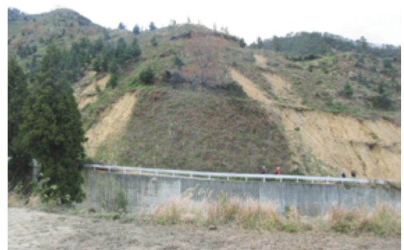
写真16 のり面における土壌浸食 急勾配長大のり面も土壌浸食の危険性が高い。とくにヘアピンカーブでは多発している。のり面緑化およびのり肩部の浸食防止措置をしっかりとっておく必要がある(写真11の赤線区域内)。
