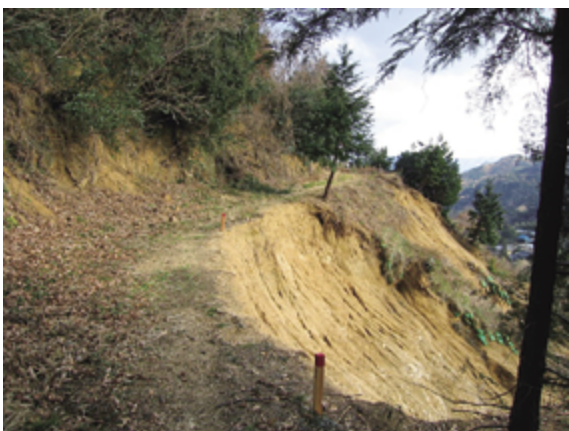
写真15 作業道の路肩から土砂崩れ発生 作業道開設時に片切り・片盛り(切土・捨土)が行われるが、地形改変を行った箇所では土砂崩れの危険性がきわめて高くなる。土砂崩れ防止対策をしっかりとっておく必要がある(写真11の赤線区域内)。
