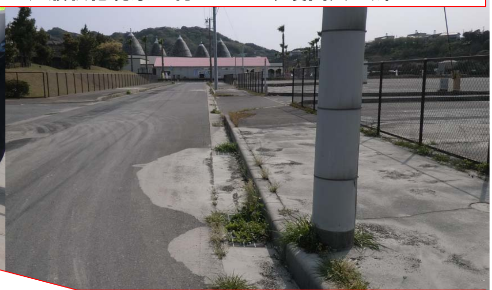
震度6弱を観測した淡路市淡路ワールドパークの道路やその周辺の地盤には、いたる所に液状化現象跡の様子（一部噴出した水が残っていた）
