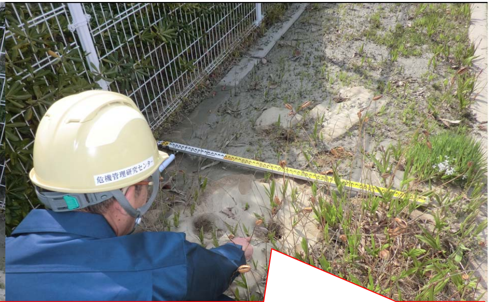
震度6弱を記録した淡路市淡路ワールドパークの道路横には、液状化現象の約10cmの砂噴出穴が残っていた
